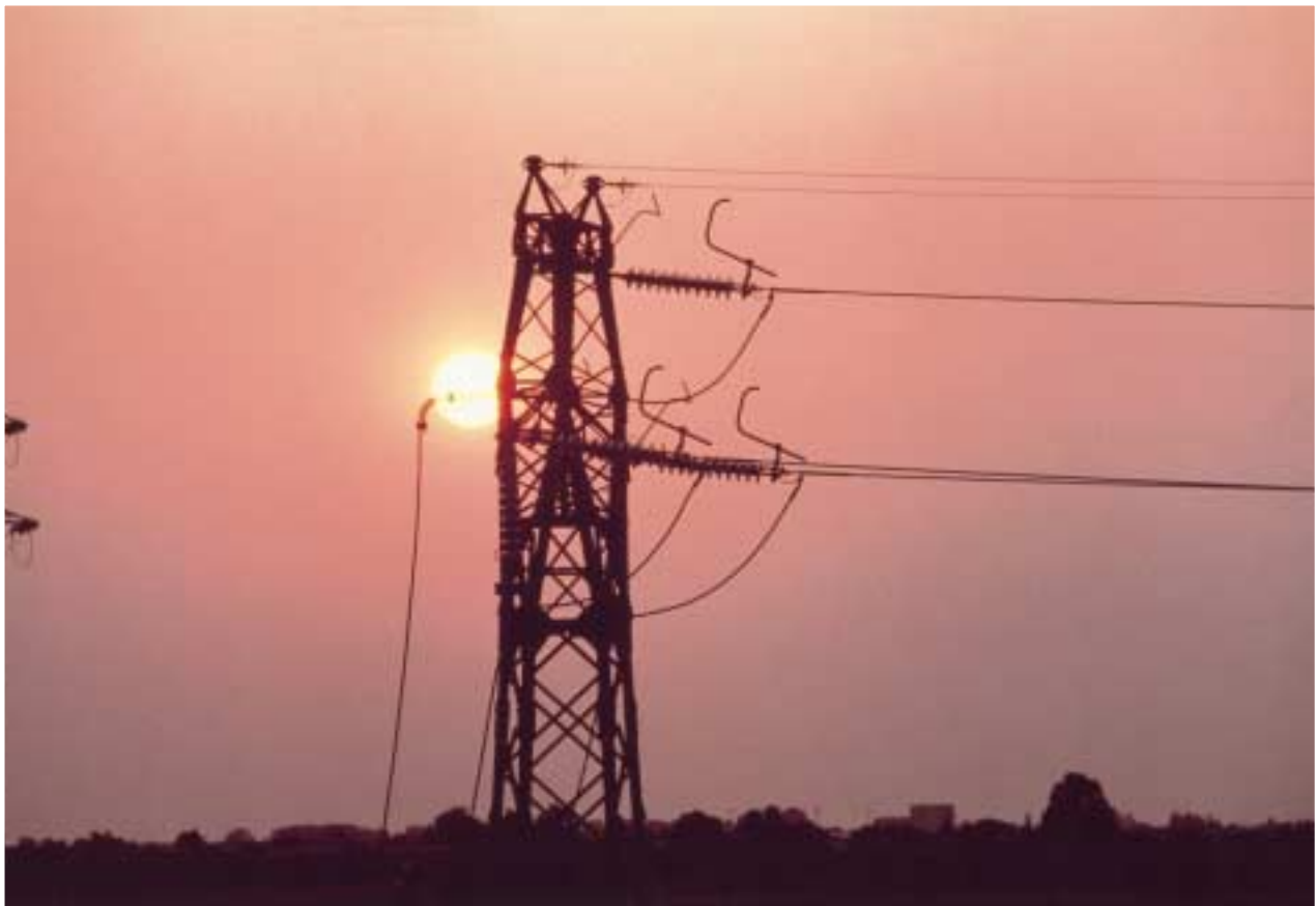
Fig. 15 - Linee elettriche di alta tensione
