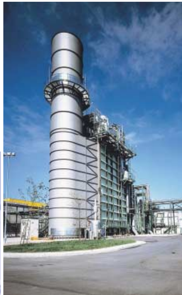
Fig. 16 - Il camino del GVR (Generatore di Vapore a Recupero)
