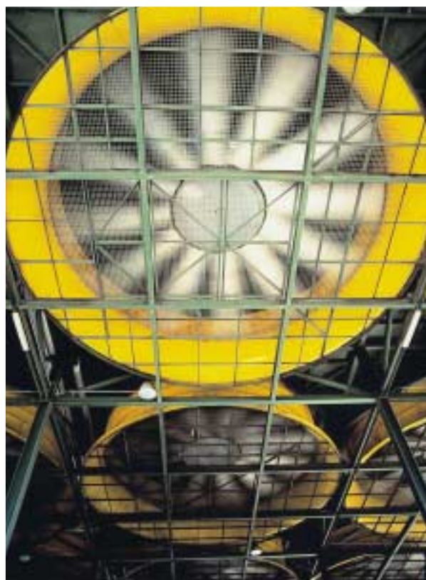
Fig. 9 - Particolare del condensatore ad aria: uno dei 12 ventilatori
