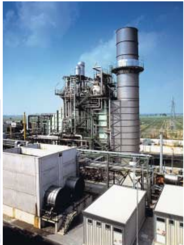
Fig. 8 - La centrale di San Quirico (in secondo piano il GVR Generatore di Vapore a Recupero)
