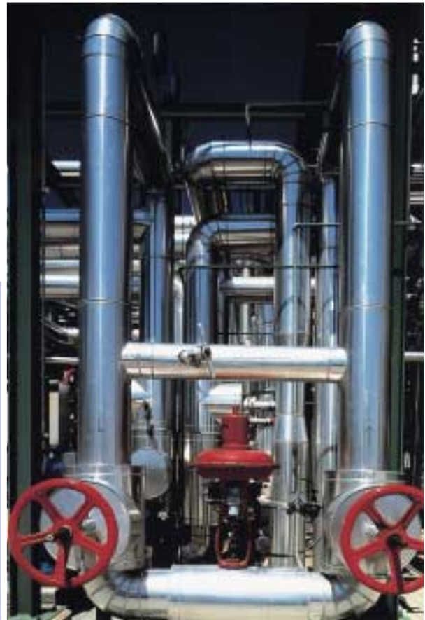
Fig. 17 - Tubazioni per il trasporto del vapore
