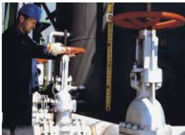
Fig. 19 - Un operatore esterno durante una manovra
